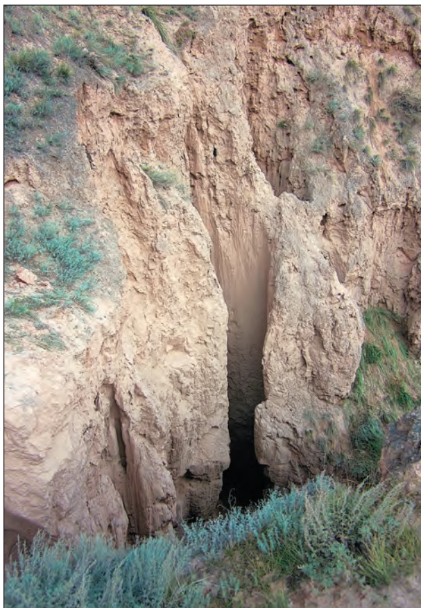
Многометровый провал, расширяющийся с глубиной. Отвесные стенки покрыты эрозионными бороздками, промытыми ливнями.
